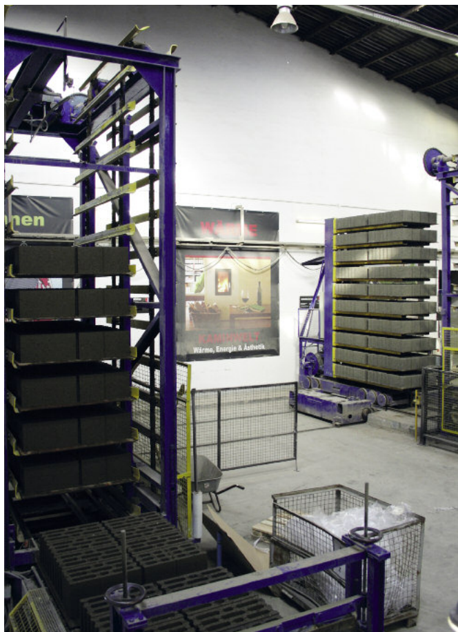
Winda piętrująca i ropiętrująca oraz wózek wielowidłowy zostały zmodernizowane.
