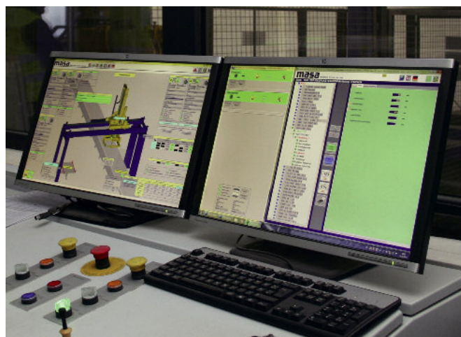
Ze sterowni widać całą linię suchą i moką. Wizualizacja pozwala na logiczną i prostą obsługę całej linii.
