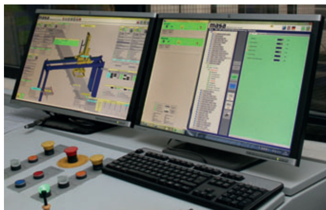
Dalla sala comandi pieno controllo del lato bagnato e di essiccazione. La visualizzazione garantisce comandi logici e semplici di tutto l'impianto.
