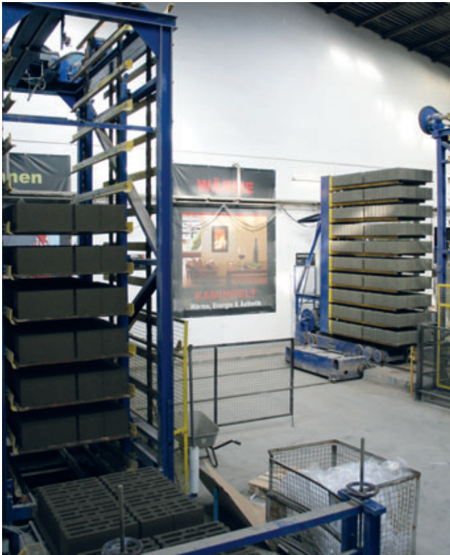
L'ascenseur et le descenseur ainsi que le chariot transbordeur ont été modernisés.
