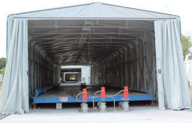
Control de válvulas para la distribución del vapor a las mesas de producción
