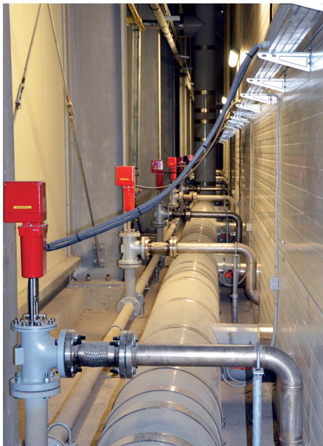
Подводящий канал с обратной стороны стеллажа с трубопроводами Varog, клапаном для каждого отсека и распределительным воздуховодом
