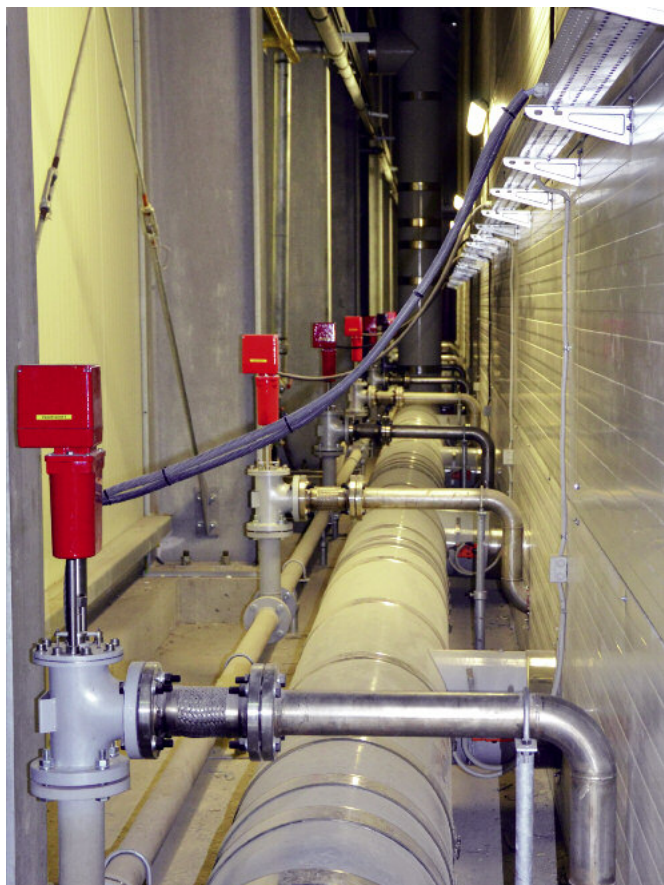
Instalacja zasilająca z tyłu regału z płytami, składająca się z przewodu doprowadzającego parę wodną, zaworu dla każdej komory i przewodu rozdzielczego powietrza.
