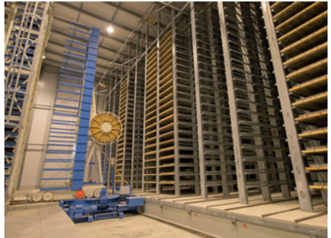
Camera di essiccazione con scaffali Rotho nel nuovo stabilimento russo della società Vibor-S: capacità complessiva 8000 tavole
