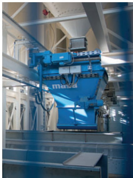
20 silos di aggregati sono a disposizione per riempire le due bilance di carica
