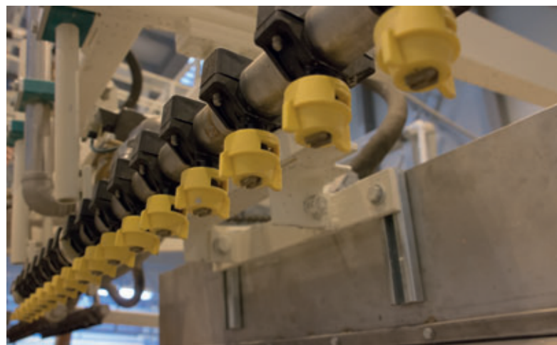
Gicleurs de l'installation de lavage Masa
