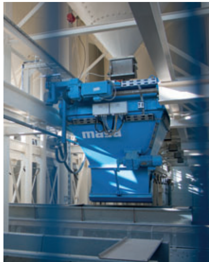
20 silos de granulat sont disponibles pour desservir les deux balances de chargement
