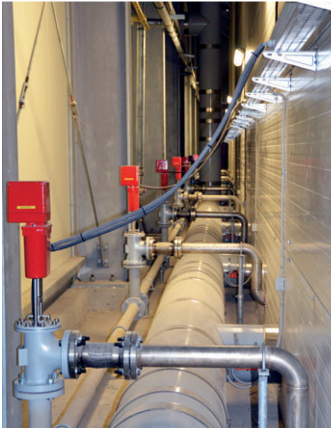
Recorrido de los conductos en la parte trasera de la estantería con conducto Vapor, una válvula para cada cámara de curado y el conducto de distribución de aire.
