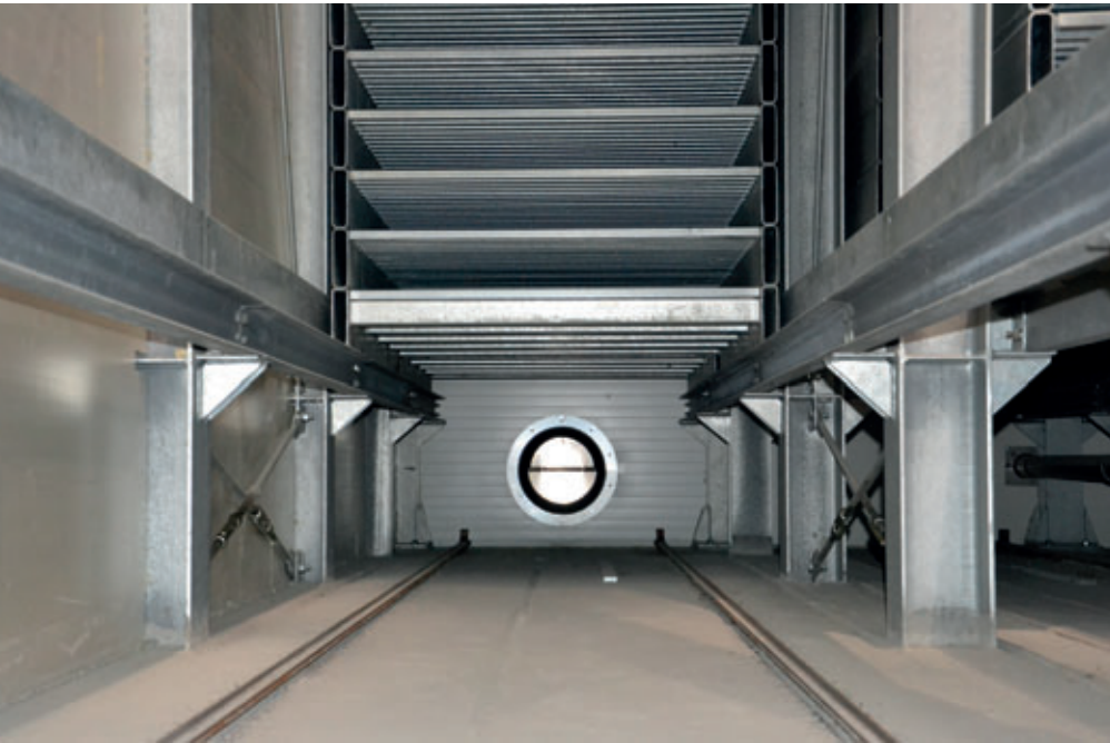
Orificio de entrada para el aire caliente debajo de la estantería.
