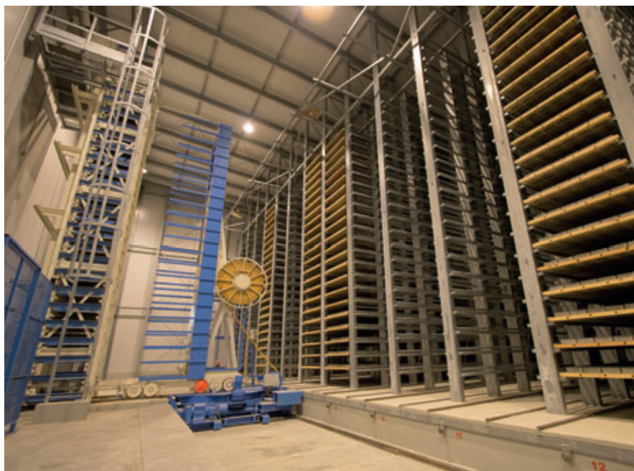
Cámara de secado con estanterías de Rotho en la nueva planta rusa de la empresa Vibor-S: capacidad total para 8000 bandejas
