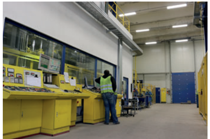
La blocchiera XL 9.1 può essere osservata attraverso il fronte della finestra dell'involucro di protezione acustica
