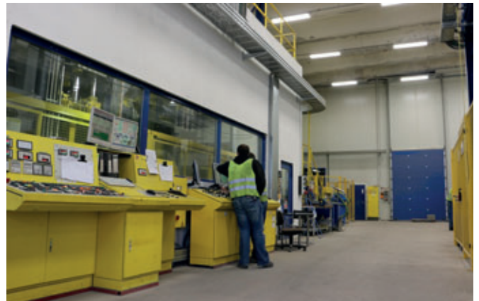
La máquina bloquera XL 9.1 se puede observar a través de la ventana frontal del cerramiento de insonorización
