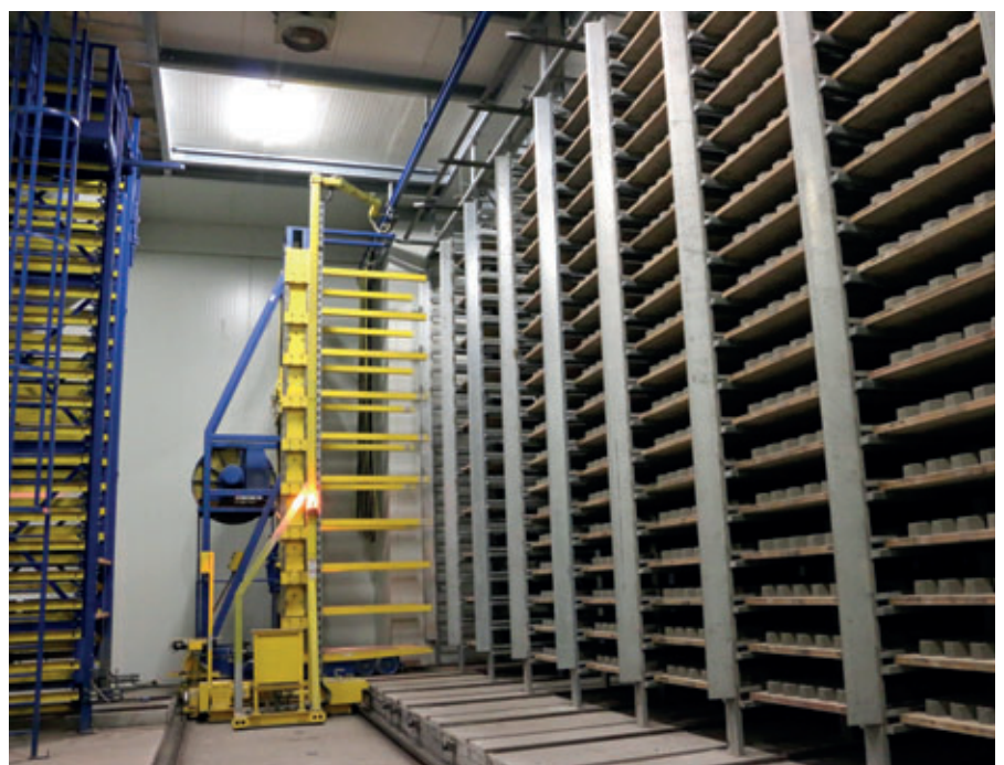
Plataforma móvil de Masa con el nuevo sistema de cámara grande y sistema de ventilación
