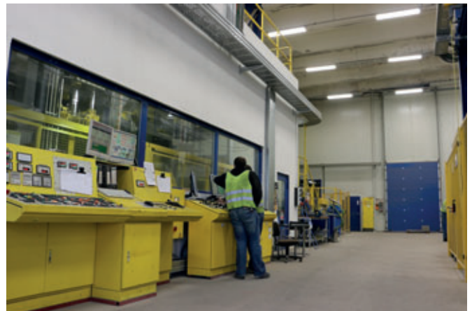
Die Betonsteinfertigungsmaschine XL 9.1 kann durch die Fensterfront der Schallschutzeinhausung beobachtet werden.
