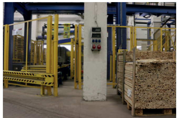
Sicheres Arbeiten und ohne Zeitverlust – dank der Lichtschranken können die Leisten ohne Störung des Gesamt Ablaufs der Anlage sicher positioniert werden.
