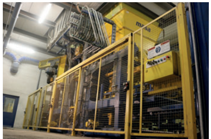
Die neue Masa-Betonsteinfertigungsmaschine XL 9.1 im Leipziger Werk der Fa. Kann
