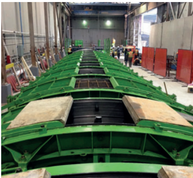
Segmentos de moldes de colado Evergreen limpios y listos para el colado. Se realizan dos colados por día, lo que significa una producción de 48 segmentos por día, es decir, 6 anillos de dovelas.
