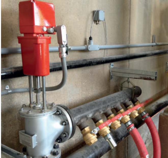
Dampfsteuerungsventil mit Schlauchanschlüssen für das Einspritzen von Dampf unterhalb der Formen
