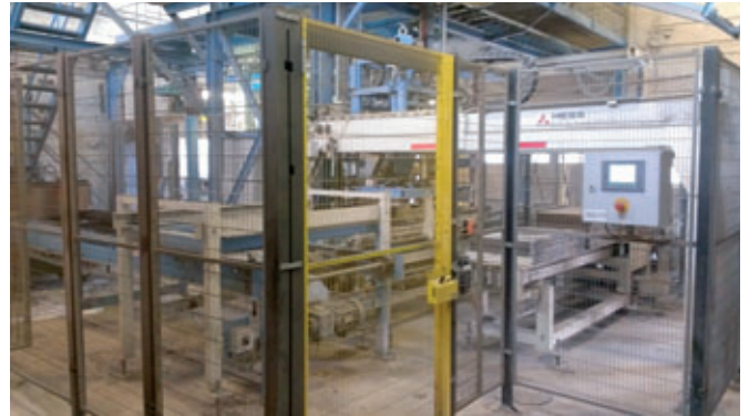
Integración de un depósito de almacenamiento intermedio en la instalación existente
