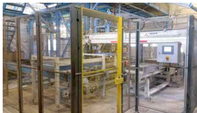
现有厂房里的一个缓冲板
