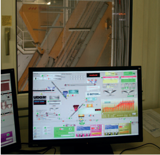
Все процессы перемешивания и дозирования управляются контроллером Sauter
