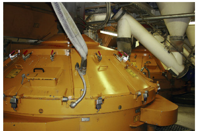
W wieżowym węźle betoniarskim zainstalowano dwie identyczne mieszarki firmy Haarp (3 750 l).
