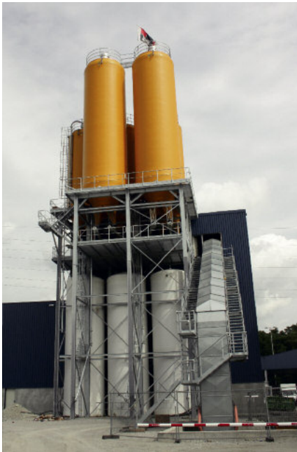
Wieżowy węzeł betoniarski koło nowej hali produkcyjnej.
