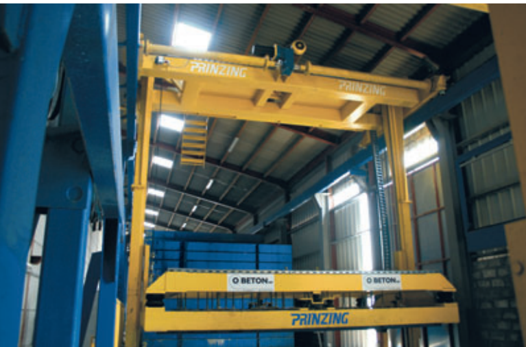
Un robot gru gestisce e rifornisce il magazzino per stampi dell'impianto di colata Zelus in modalità completamente automatica.
