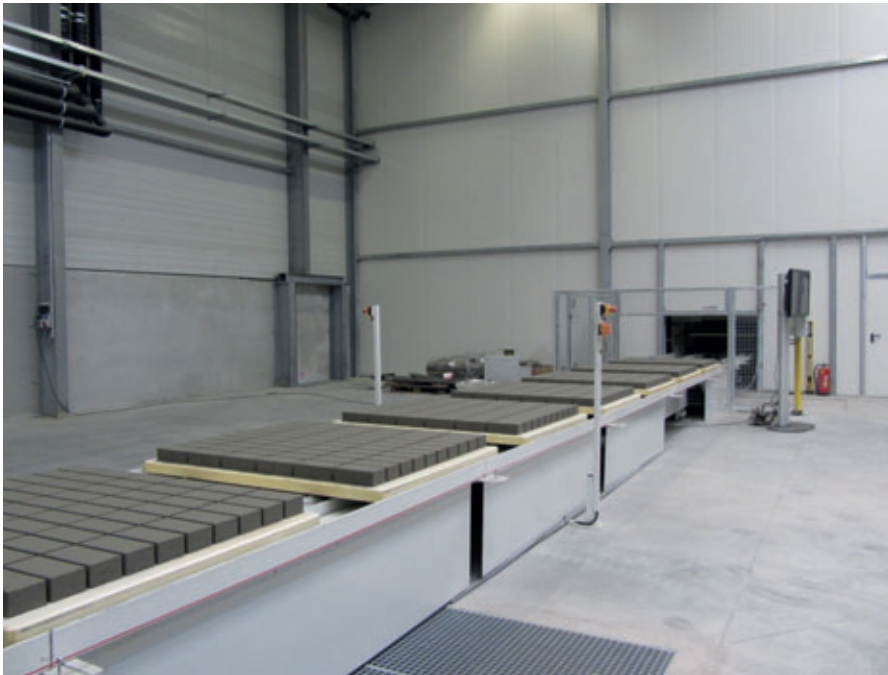
Installation de transport côté humide
