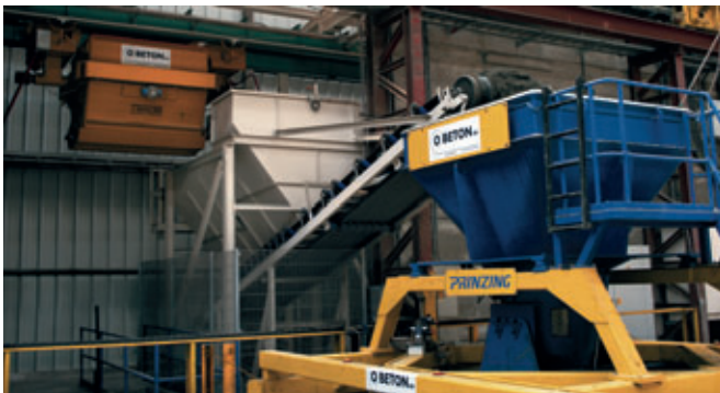
L'Atlas est alimentée en béton à consistance de terre humide par un convoyeur à benne et un présilo
