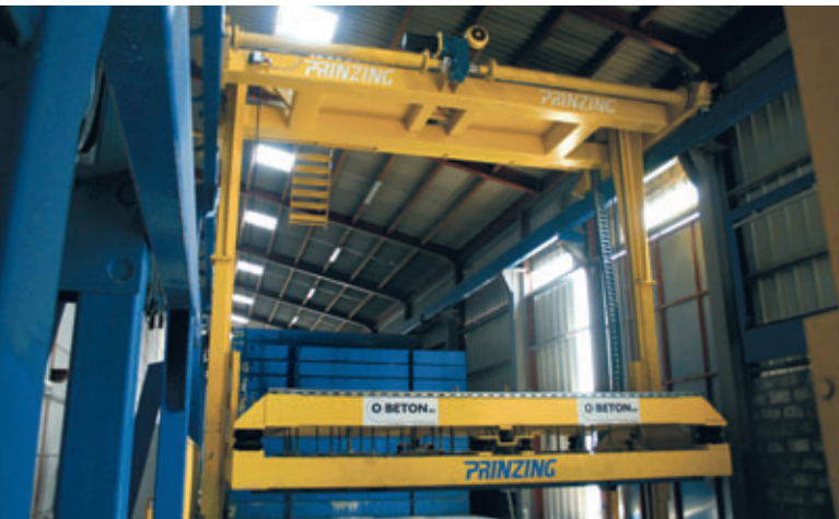
Un robot grúa administra y maneja el almacén de moldes de la instalación de colada Zelus de forma completamente automática.
