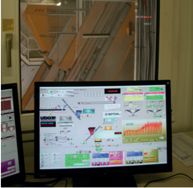
Todos los procesos de mezcla y dosificación son controlados con el sistema de control de Sauter
