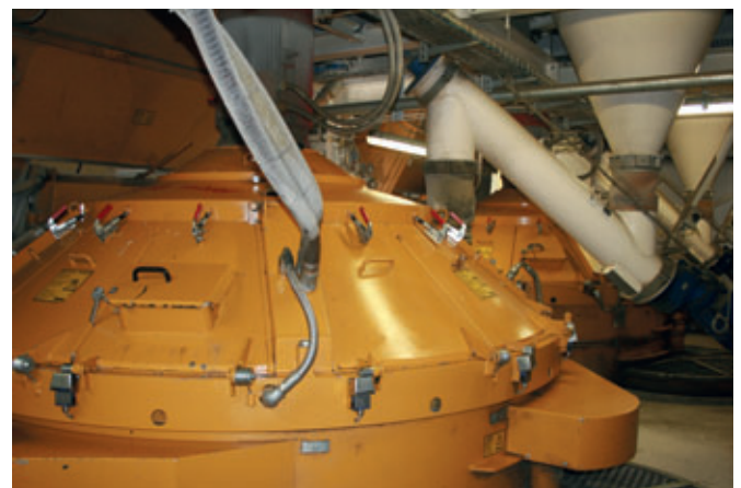
En la torre de mezcla se instalaron dos mezcladoras idénticas de Haarup (3750 l).
