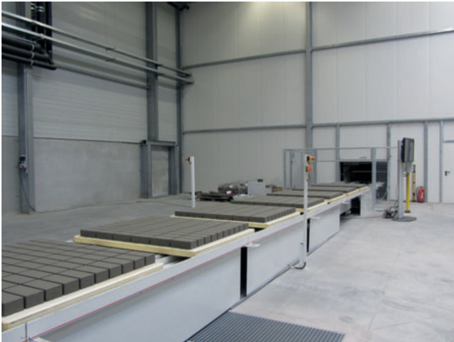
Instalación de transporte lado húmedo
