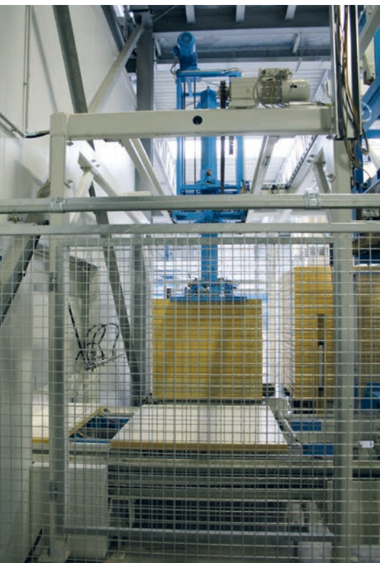
传送装置将封包的栈板放置到混凝土砌块成型机的栈板入口
