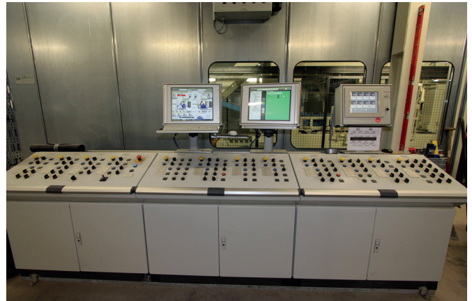
Пульт управления расположен непосредственно перед шумоизолирующей капсулой установки Masa XL 9.2
