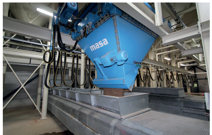
БСУ перерабатывают бетон того качества, которое удовлетворяет определенным требованиям последующего бетонного производства
