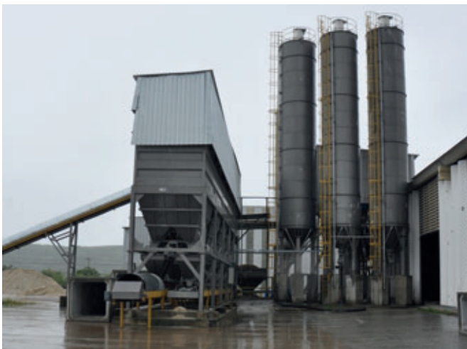
Instalación de dosificación y mezcla
