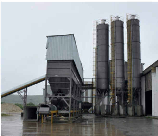
Dosier- und Mischanlage
