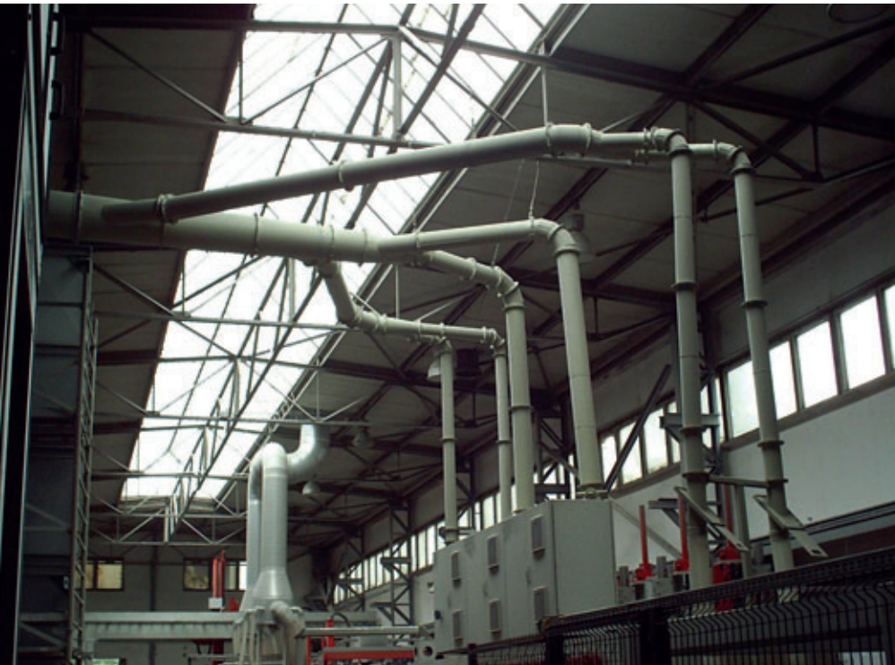
Tuyaux de raccordement aux installations d'aspiration indépendantes
