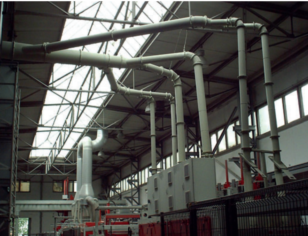
Tuberías de las plantas aspiradoras situadas separadas
