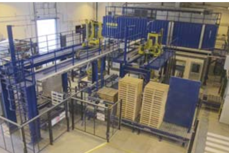
Nowa linia technologiczna firmy Masa w zakładzie Saint-Gobain Weber w Oitti, Finlandia - przejrzysta i wyposażona w obszerne zabezpieczenia.
