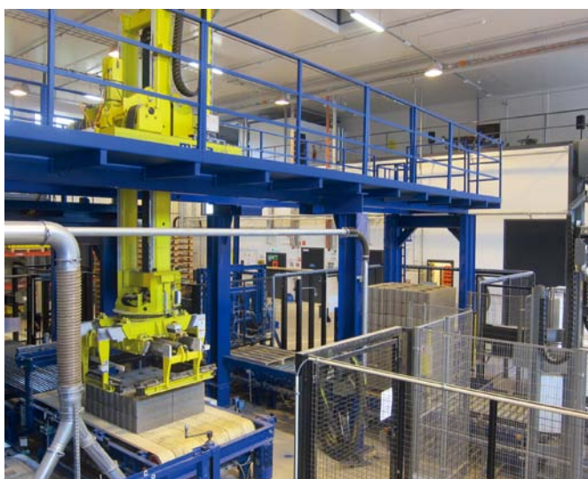
第二个抓取机器人处理两个混凝土层块，他们之前经由双层叠加机处理过，再在后面的支架上用其制造砌块包装
