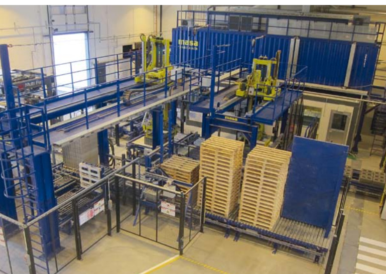
布局清晰，安装准确，体现了广泛的安全技术应用：芬兰 Oitti 市 Saint-Gobain Weber 公司内新建 Masa 混凝土砌块生产工厂
