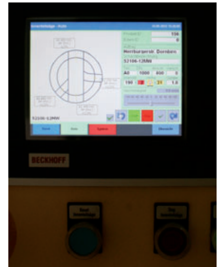
La commande des procédés de fabrication s'effectue au moyen d'écrans très intuitifs installés sur les différentes stations de travail.
