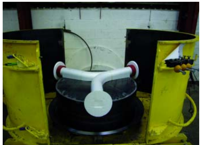
Заготовки водоводов из пенополистирола укладываются в стальную форму для заливки самоуплотняющимся бетоном
