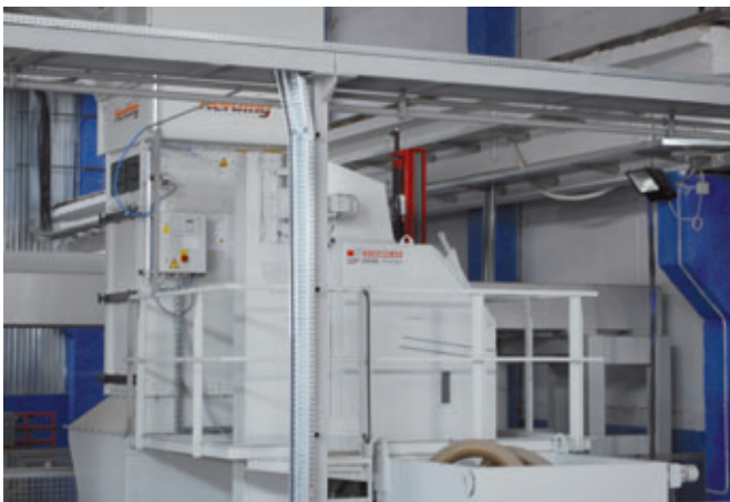
Installation de grenailage avec filtre à lamelles frittées
