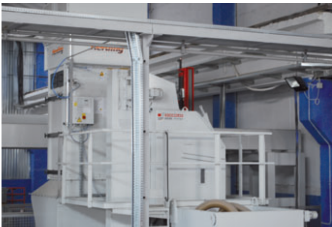
Strahlanlage mit Sinterlamellenfilter
