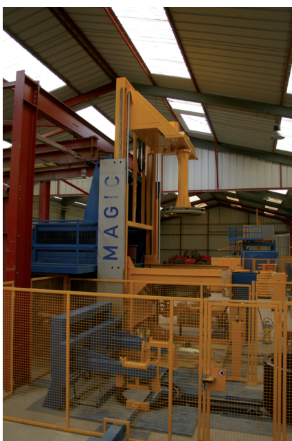
Il nuovo impianto di produzione Magic 1501- di Bonna Sabla nello stabilimento di produzione di pezzi prefabbricati in calcestruzzo di Bruz
