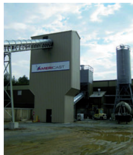
Завод в Ашленде, на котором установлена Exact1500 (Schlüsselbauer), имеет четыре силосные башни вместимостью 60 тонн для заполнителя и еще две силосные башни для цемента и летучей золы. Допускается замена 25% цемента на летучую золу.
