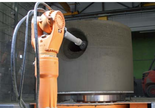
铣削头沿环形轨道移动，对混凝土进行层层铣削直至达到总体壁厚厚度
