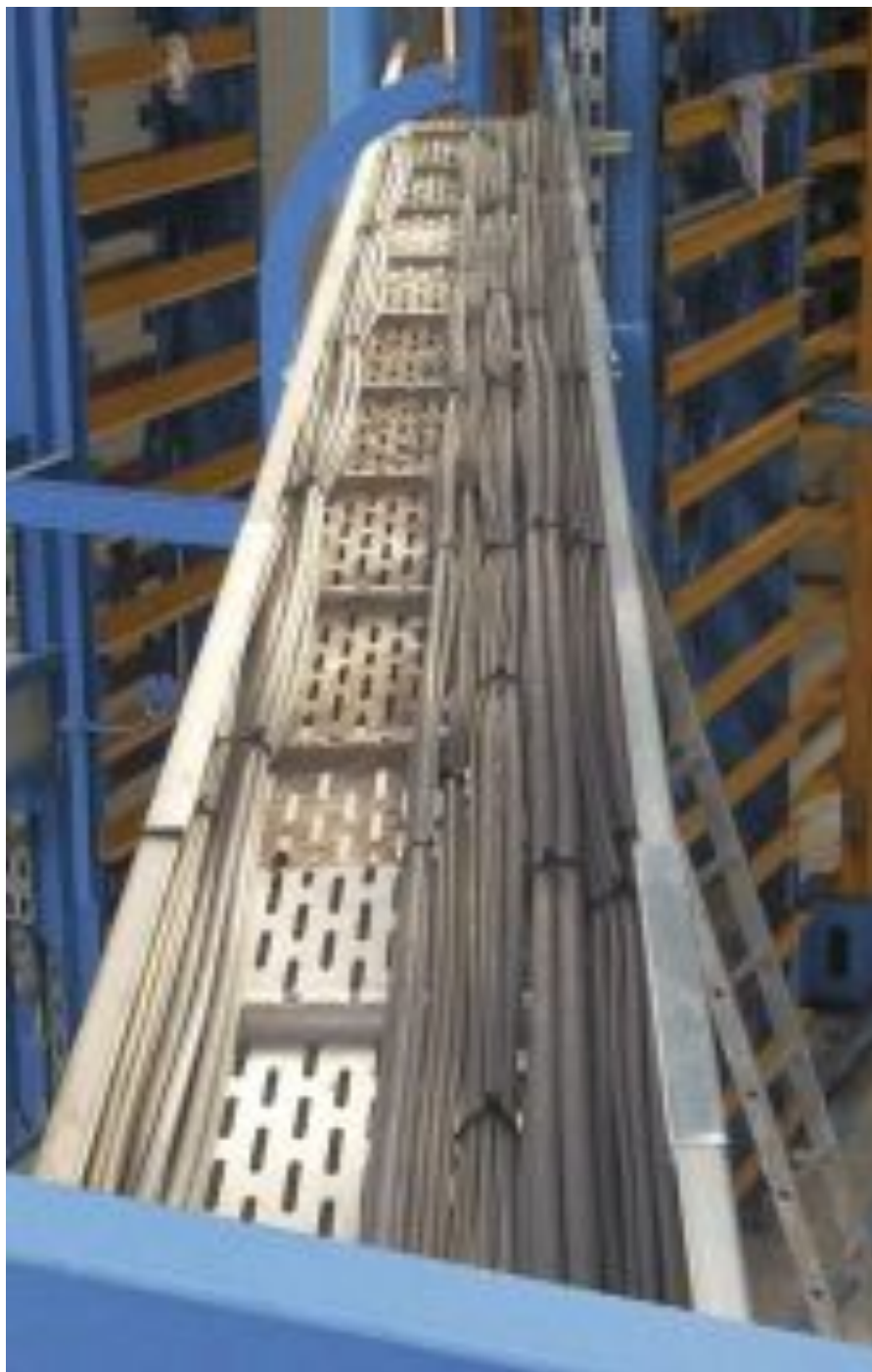
Kable ułożone w specjalnych korytkach kablowych.
