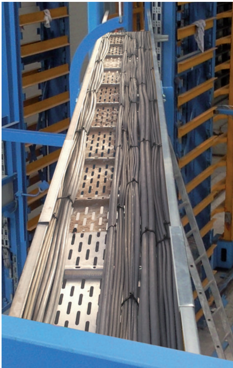
Passaggio dei cavi tramite i tracciati per cavi
