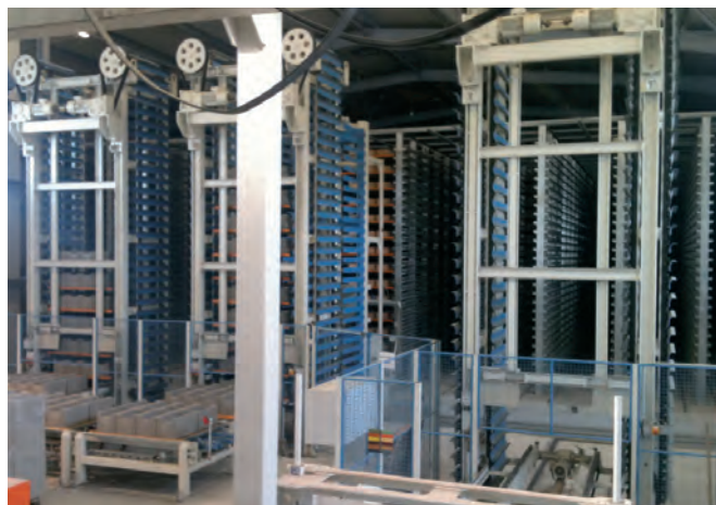
Слева 2 опускающих и справа 2 подъемных штабелера
