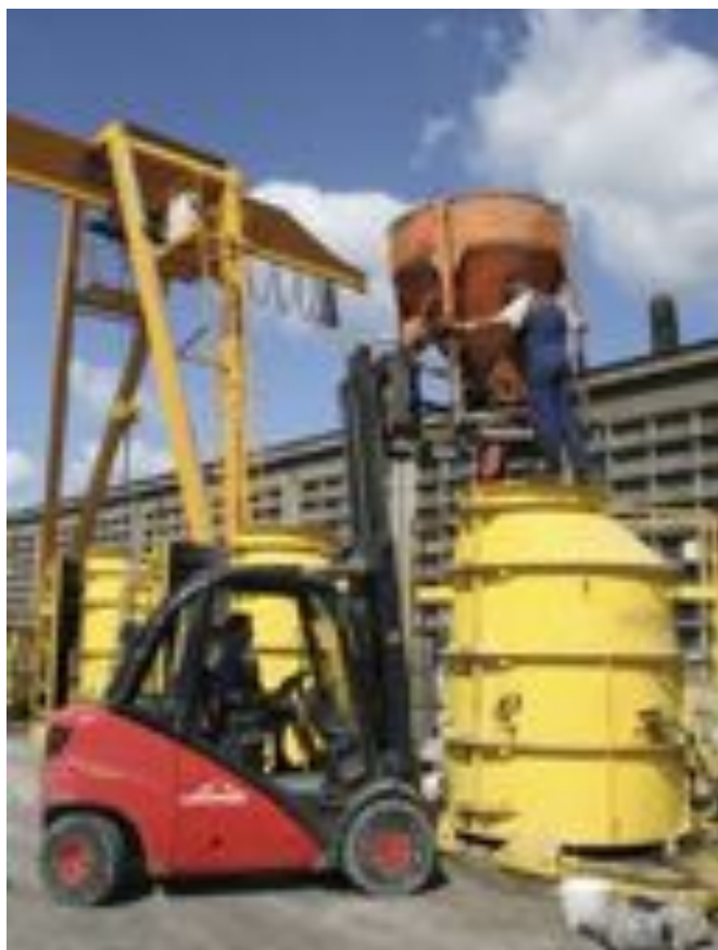
Zalewanie betonem następuje za pomocą wózka widłowego i silosu. Tak jak systemie Perfect stosowany jest wyłącznie beton samozagęszczalny SCC.
