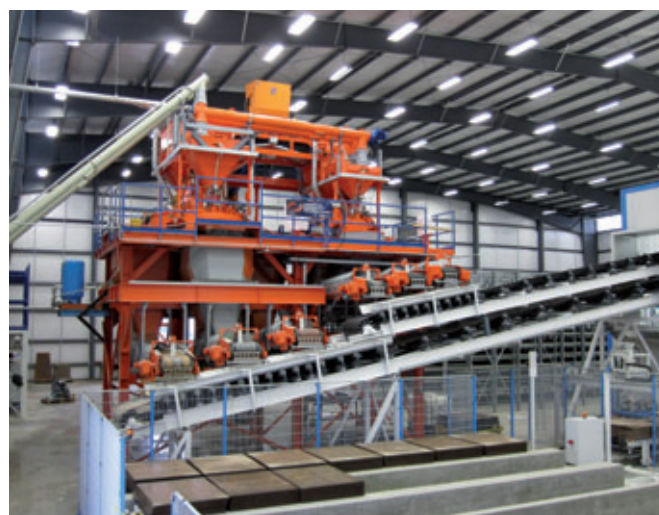
Fig. 6: Fanno parte dell'impianto di betonaggio ACT MobilMat (sullo sfondo) un impianto di betonaggio a doppio asse con un miscelatore ad alte prestazioni HPGM 2250 e un HPGM 750, con i quali vengono alimentate tre tramogge per calcestruzzo ciascuno e si possono preparare automaticamente tre diverse miscele di calcestruzzo, dalle quali poi si possono produrre manufatti d'alta qualità completamente colorati oppure colorati solo dalla parte del calcestruzzo in vista. Con il sistema di mescolazione del calcestruzzo ACT MobilMat, dotato di sistema di dosaggio dell'acqua a microonde ACT HYDROMAT per il mantenimento di un rapporto costante acqua-cemento, si produce sempre calcestruzzo d'alta qualità. Con il sistema Hess sui pallet di produzione in lamiera d'acciaio di grandi dimensioni si producono pavé ed elementi per muri di contenimento.
