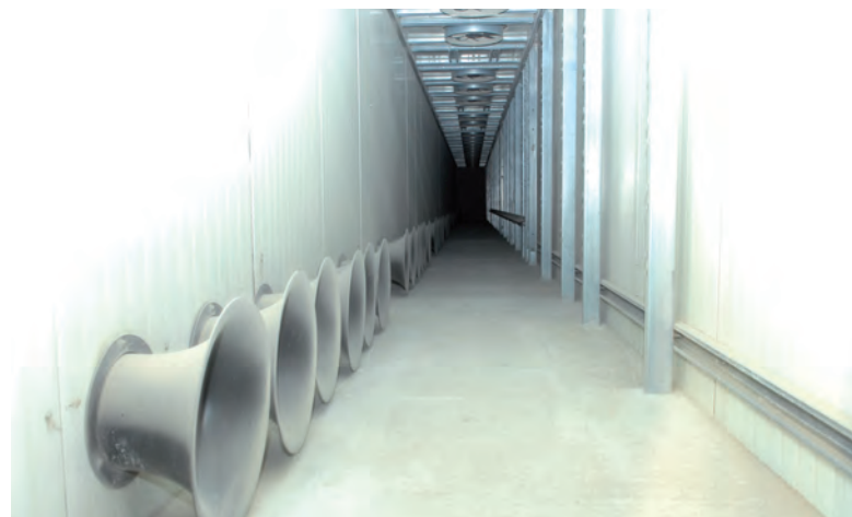
Вентиляционная установка камеры
