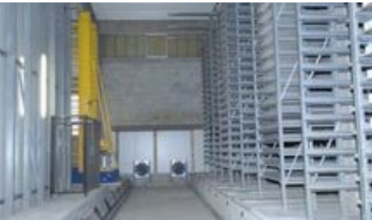
Winda piętrująca i system regałów dojrzewania.
