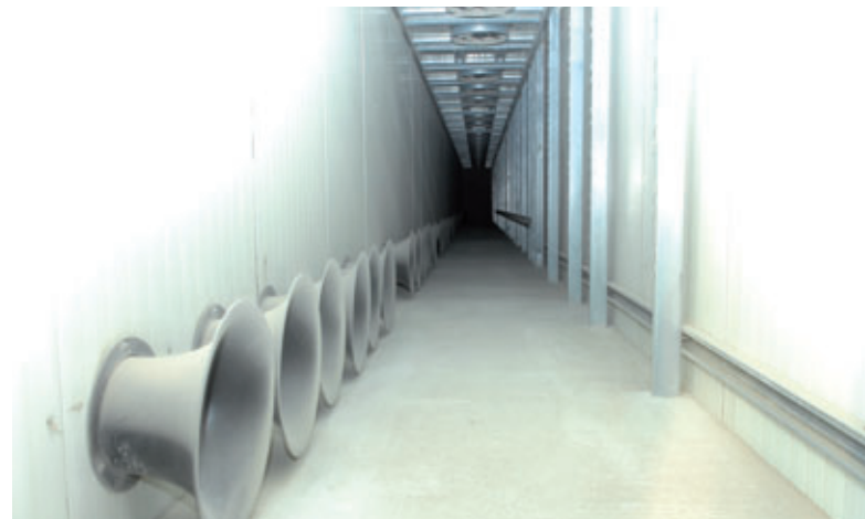
Installation de ventilation pour grands compartiments
