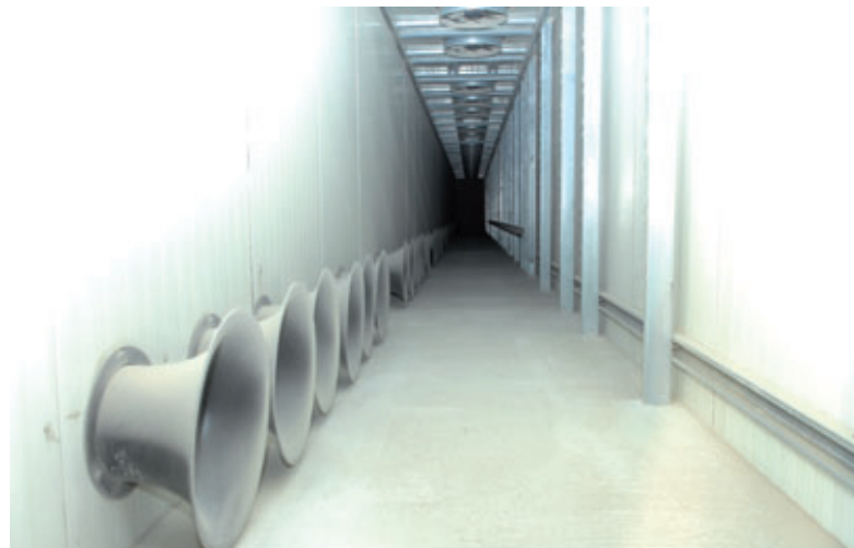
Lüftungsanlage für Großkammer
