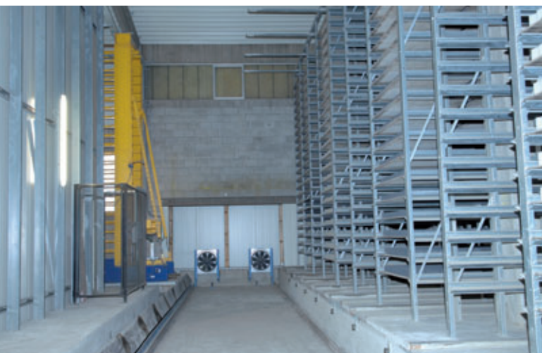
Vorlift und Regalanlage
