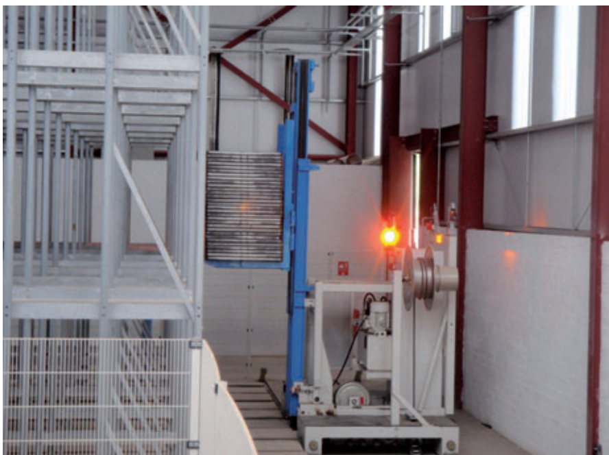
Vagone di accumulo dei pannelli
